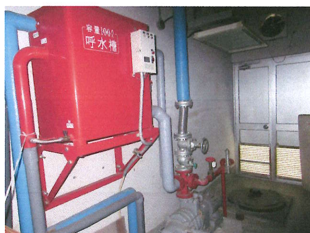
1F ポンプ室
