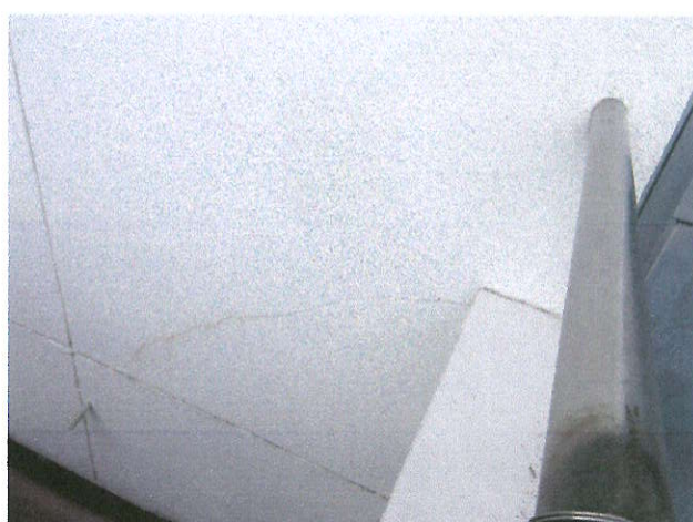
事務所棟2Fの外壁のクラックの一部
