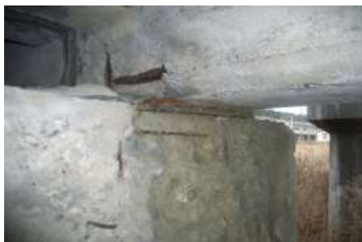
塩害が原因と推定される損傷事例
