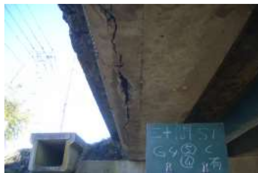
凍害が原因と推定される損傷事例
