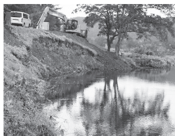
早期の復旧が待たれる野中頭首工左岸上流部の土羽護岸
