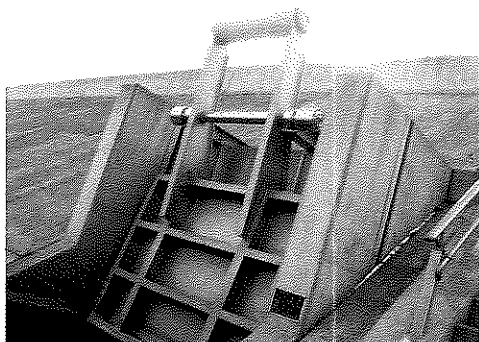
久慈湊地区のフラップ式水門
