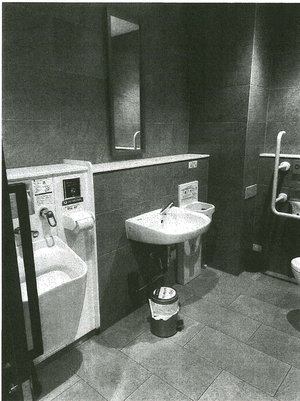
非常用トイレ
